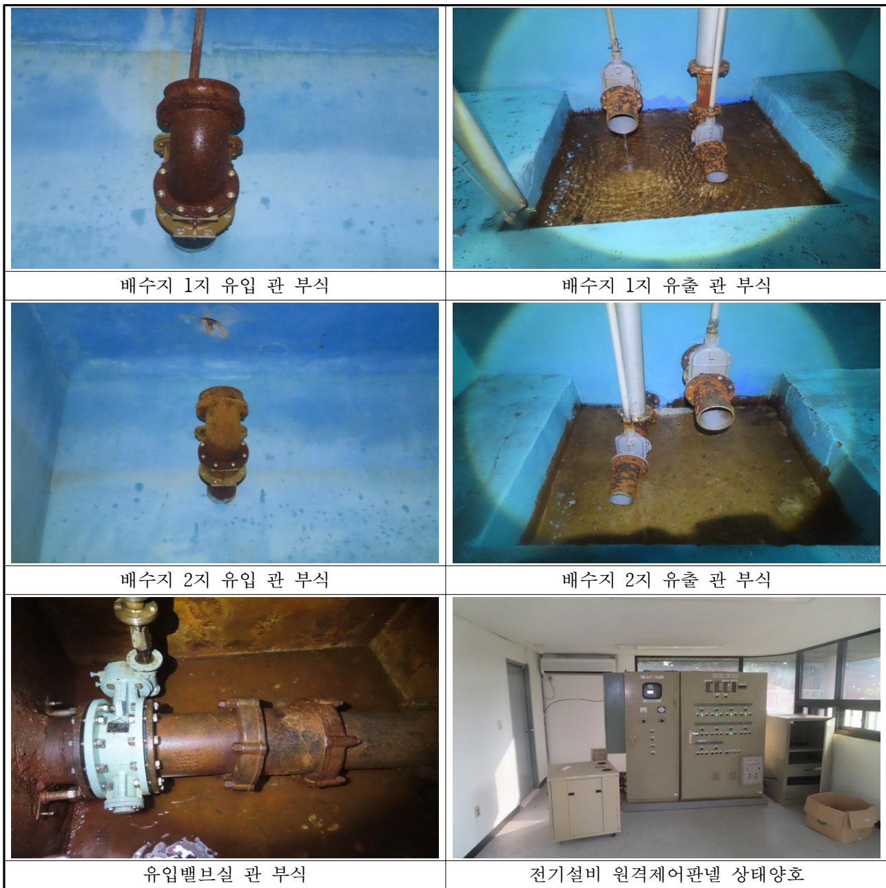
【사진 3.7】 기전설비 손상사진
