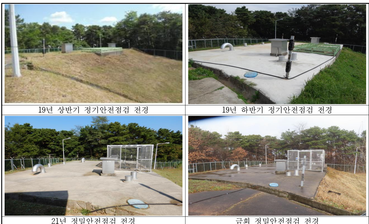
【사진 3.6】 배수지 상부구조물 손상사진
