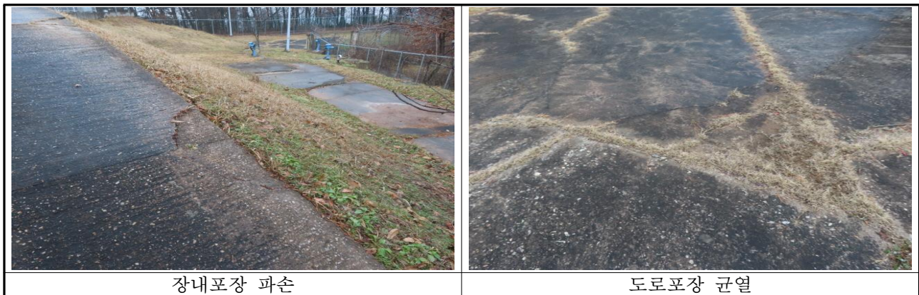
【사진 3.11】 도로포장 손상사진
