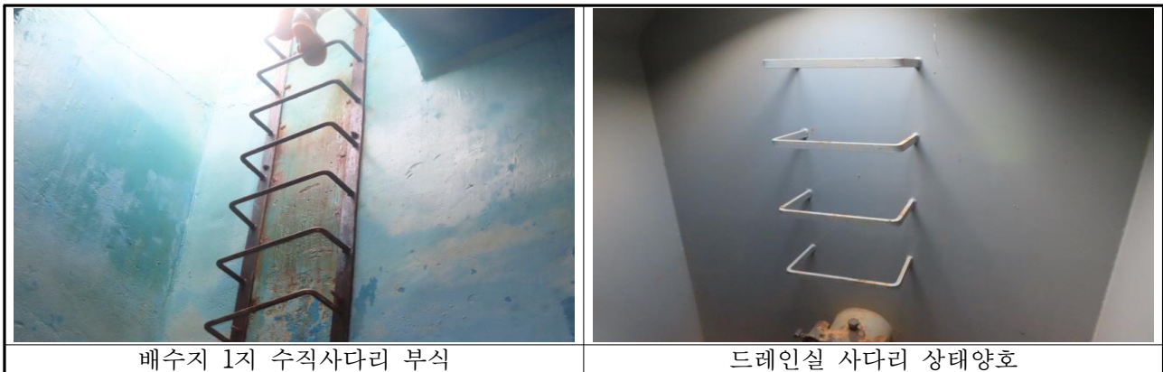
【사진 3.10】 추락방지시설 손상사진
