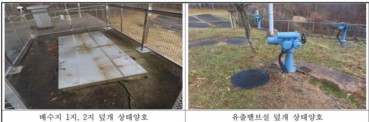
【사진 3.12】 환기구 등의 덮개 손상사진
