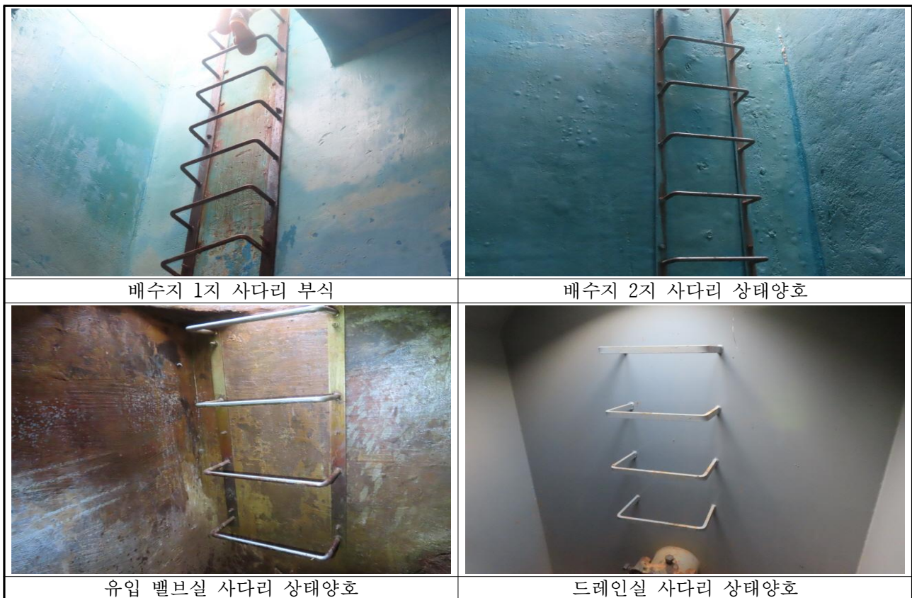
【사진 3.8】 안전시설(점검로) 손상사진
